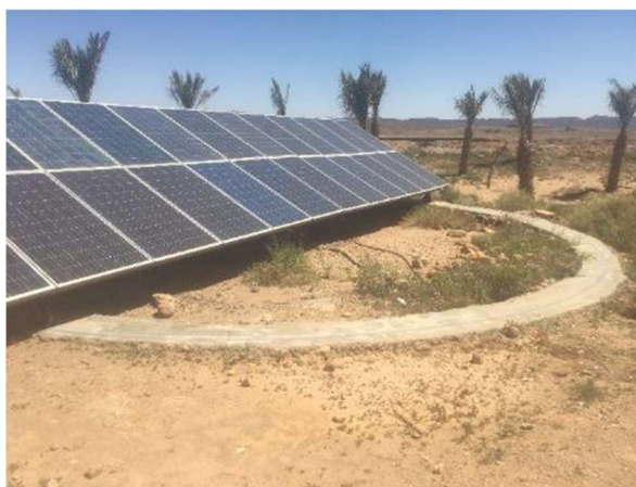
Fig. n°57 : Panneau solaire permettant de fournir l'énergie nécessaire pour pomper l'eau d'un forage à Ghallil Réalisation: P. Mazari, 2022
