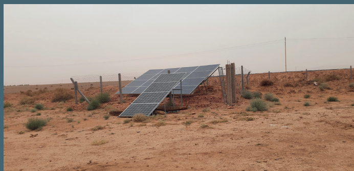
Panneau solaire alimentant un forage pour renforcer le débit d'une khattara au Maroc
