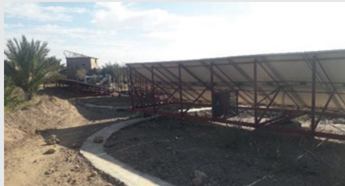
Panneau solaire mobile manuellement au Maroc
