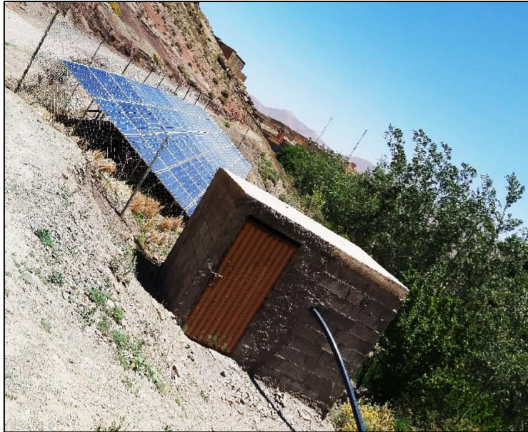
Figure 32 : Un puit d'irrigation d'Ait ounebgui-Ait izza
