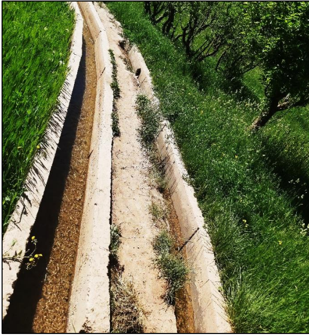
Figure 28 : Seguia en béton
