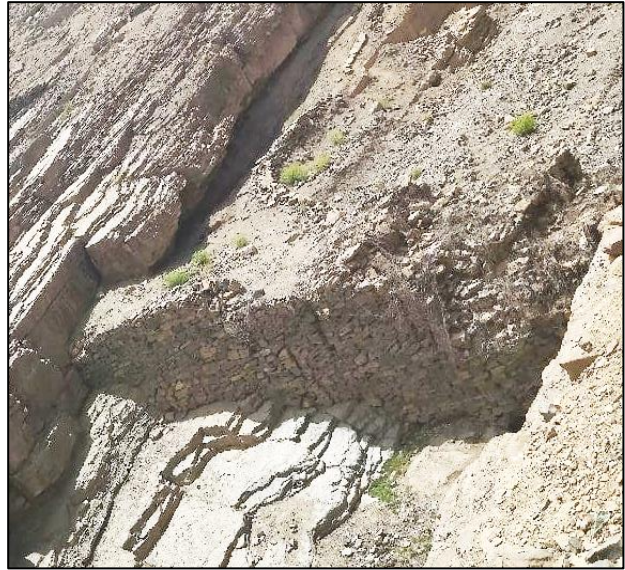
Figure 40 : Gabion d'Anmitter endommagé par des crues
