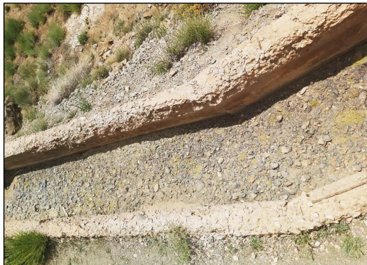
Figure 50 : Détérioration des seguias
