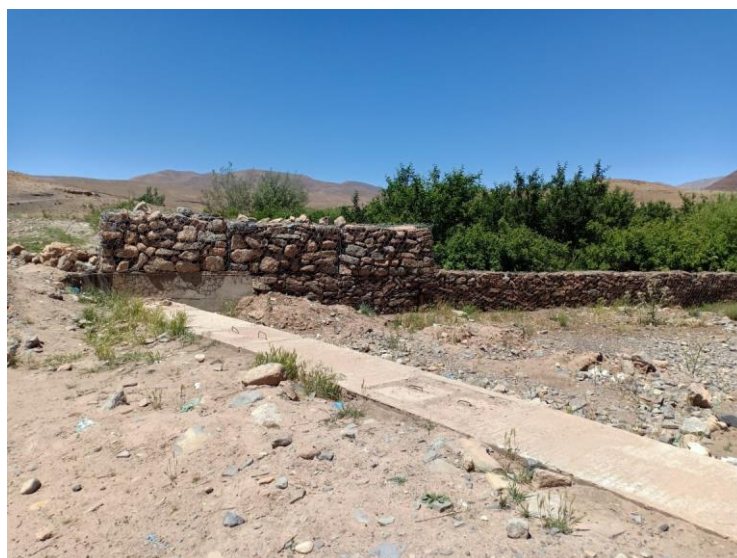
Photo 4 : Gabion contre les crues
