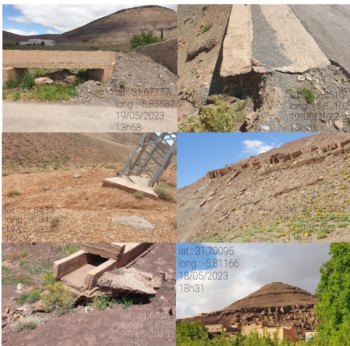
Photo 10 : Destruction des aménagements et chutes des blocs
