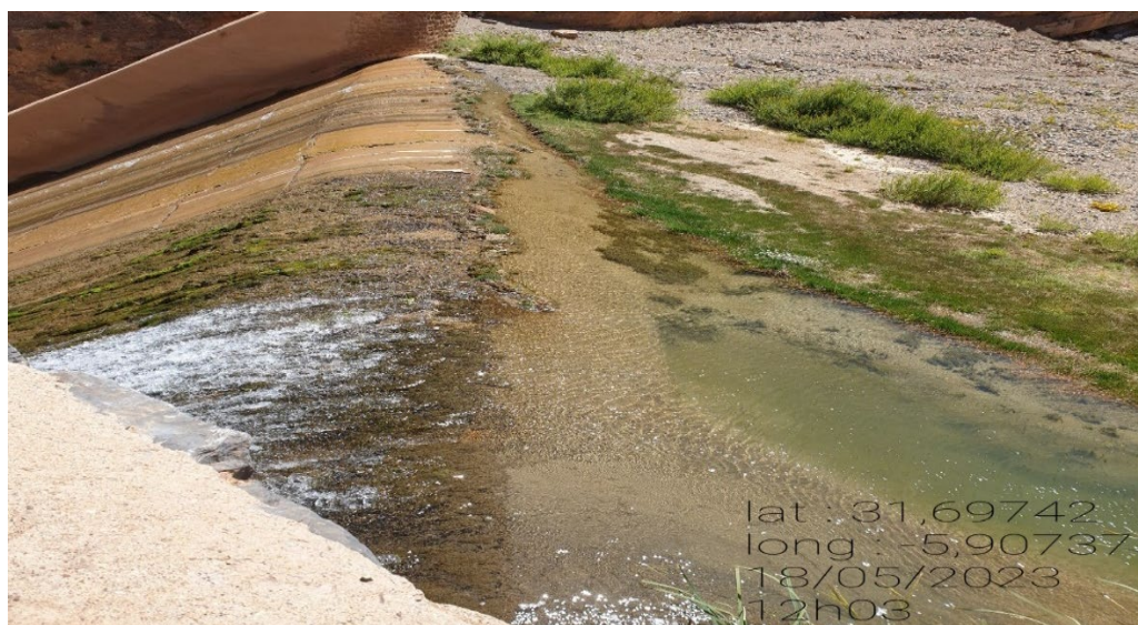
Photo 12 : Barrage totalement ensablé
