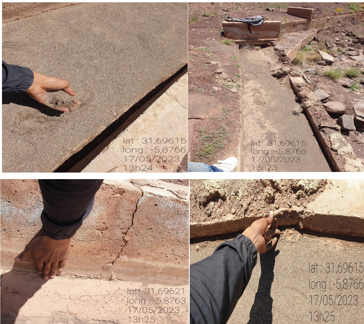
Photo 13 : Impacts de l'érosion sur les séguias
