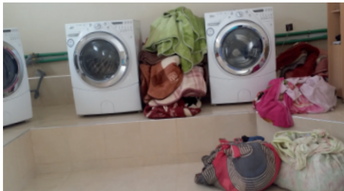
Figure 22 : Salle des Machines
