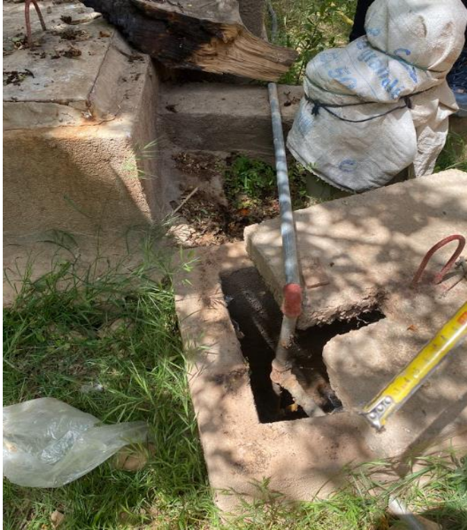
Figure 27 : Conduite de biogaz produit par le RAC
