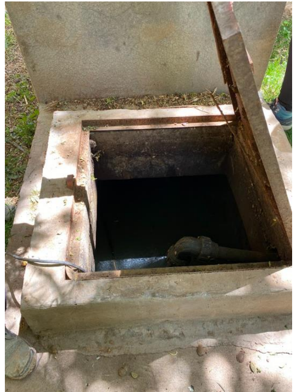
Figure 26 : Cuve des eaux usées traitées par le RAC
