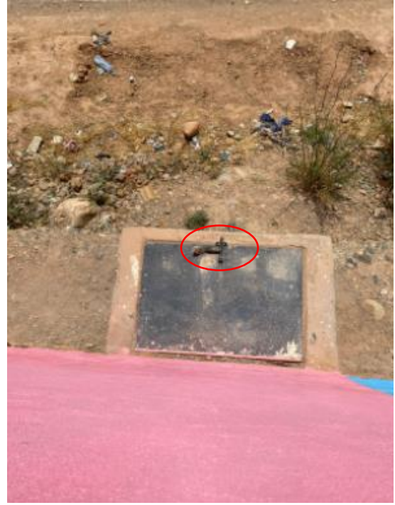
Figure 62 : Robinet de collecte des urines hygiénisées situé en dehors de l'école primaire
