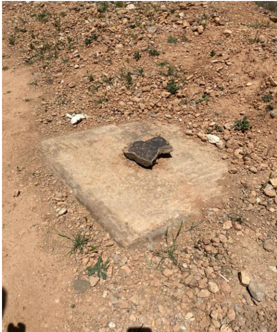
Figure 78 : Puits perdu d'un ménage du Village Ait Oufi - Commune ASJS
