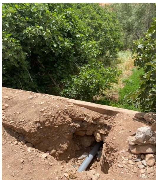
Figure 77: Conduite d'évacuation des eaux usées - Village Ait Oufi - Commune ASJS
