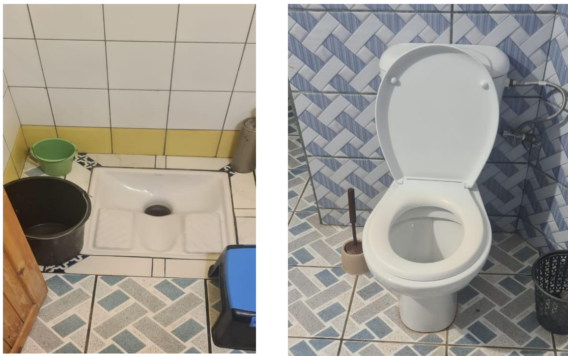
Figure 76 : Cuvette à chasse d'eau et cuvette à chasse d'eau mécanique au niveau du même ménage – Village Ait Oufi – Commune ASJS
