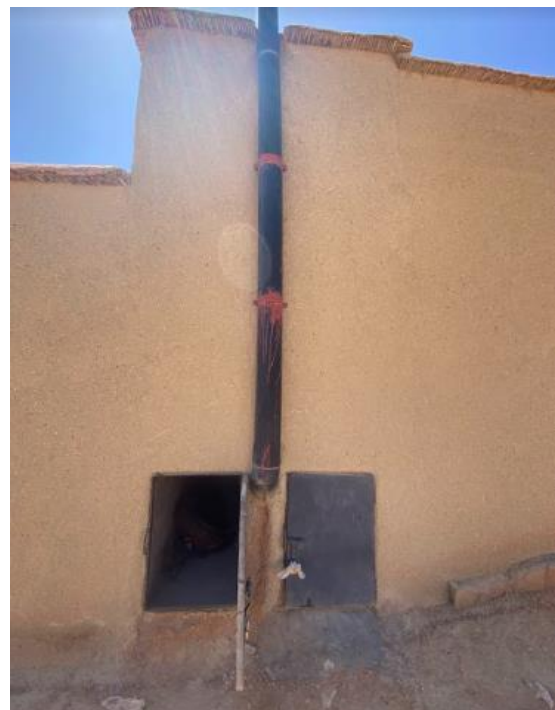
Figure 58: Chambres de déshydratation de la TDSU du ménage, munies d'un tube de ventilation
