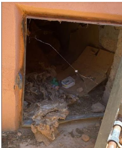
Figure 68 : Vue de près d'une chambre de déshydratation d'une TDSU existante au niveau du marché du village Ait idir
