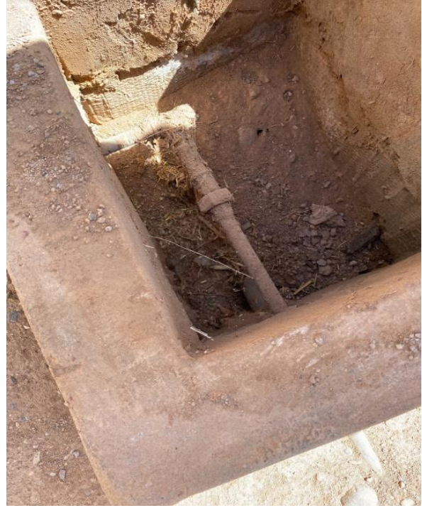
Figure 47 : Conduite du biogaz produit par le digesteur
