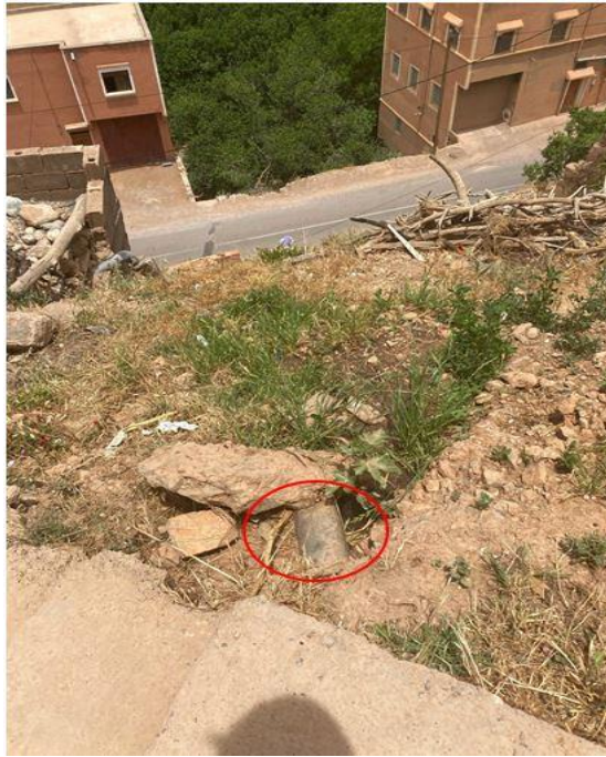
Figure 81 : Conduite de sortie des eaux de la machine à laver au niveau d'un ménage du village Ait Oufi - Commune ASJS
