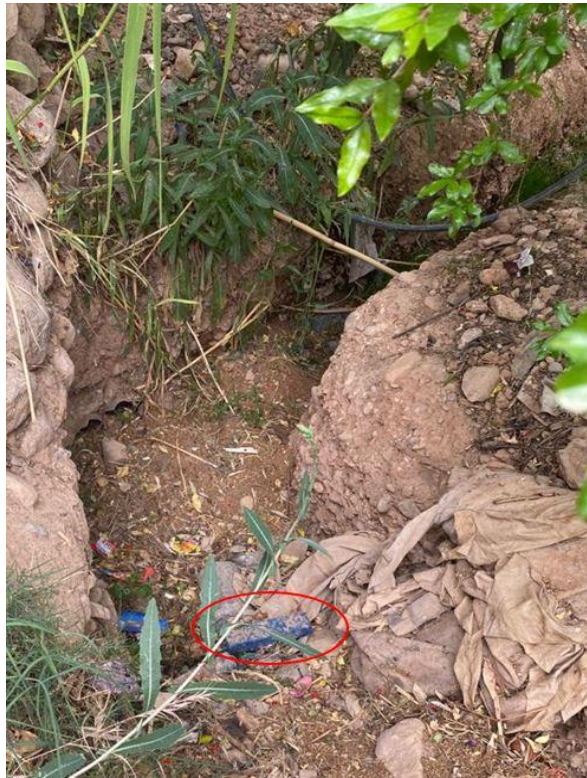
Figure 29 : Canalisation avec vanne pour la vidange du RAC (La vanne est entourée en rouge)
