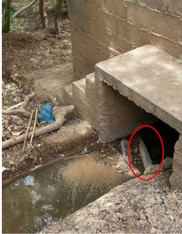
Figure 92 : Passage d'une conduite des eaux usées d'un ménage par la Seguia – Village Ait Oufi – Commune ASJS
