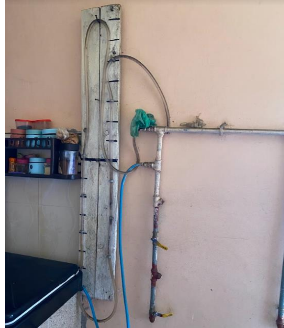
Figure 50 : Conduite d'alimentation en biogaz au niveau de la cuisine du ménage et le tuyau d'indication de son niveau
