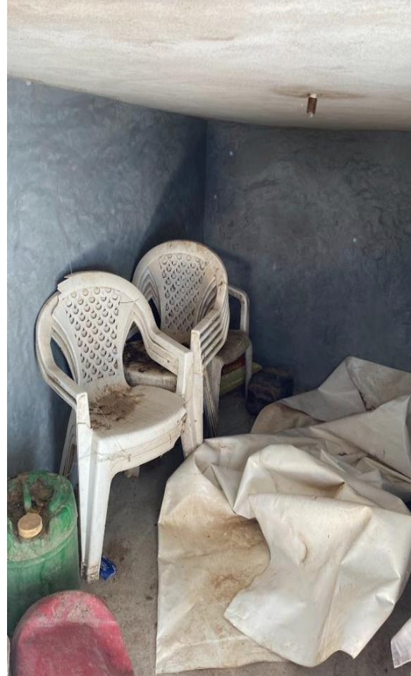
Figure 41 : Géomembrane détériorée au niveau de l'abri à gazomètre
