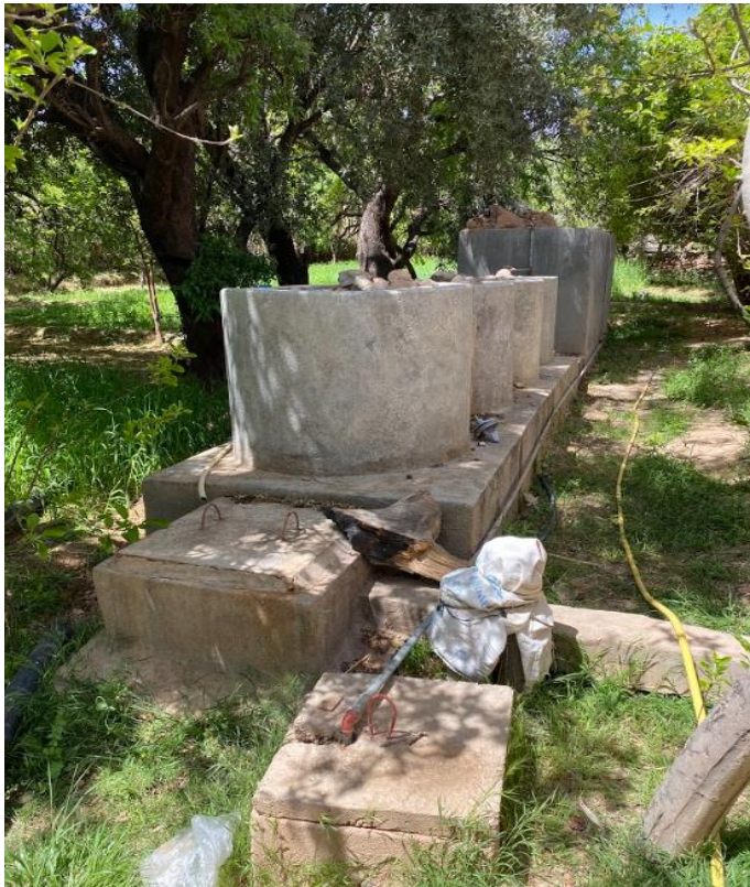
Figure 25 : Réacteur anaérobie compartimenté au niveau du ménage de Yamini Sghir
