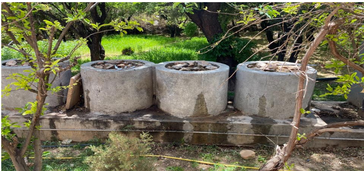
Figure 32 : Fuites d'eau suite aux fissurations du béton
