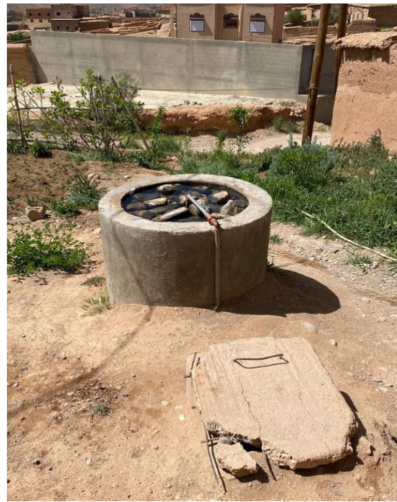
Figure 45 : Regard de la cuve centrale du digesteur munie d'une conduite de biogaz
