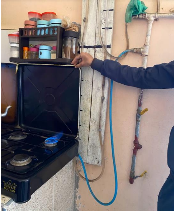
Figure 49 : Alimentation du réchaud par le biogaz produit au niveau du digesteur
